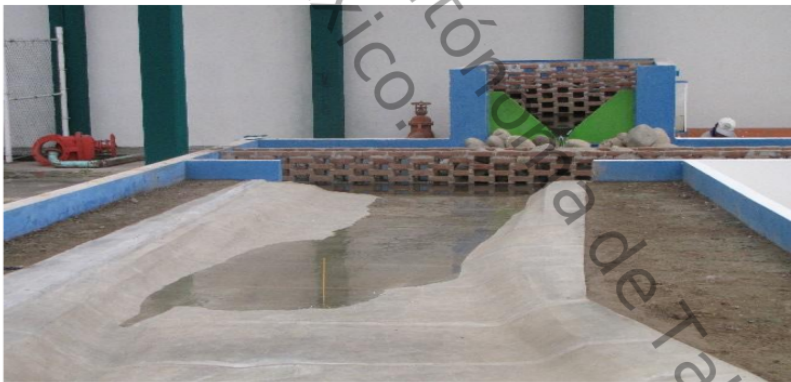
Figura 2. 20 Inicio de funcionamiento de la estructura con gastos relativamente bajos.
