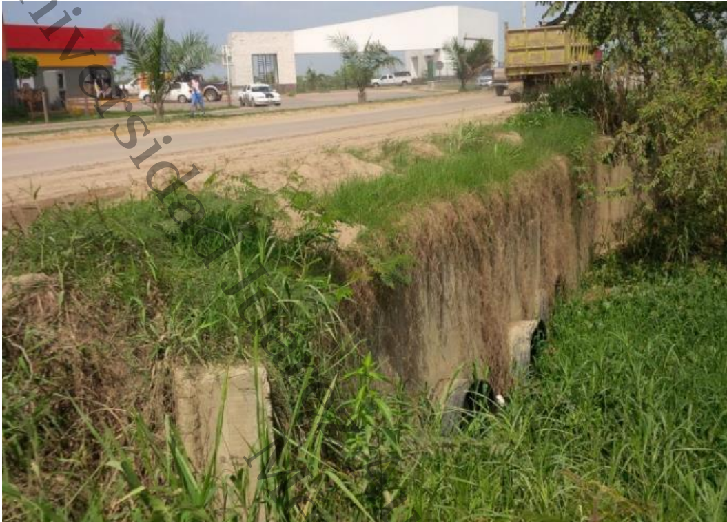
Figura 9 Ductos Pluvial ubicado en la vialidad Avenida Bicentenario (Prolongación de Paseo Usumacinta), que provoca la retención de la microcuenca Mazaltepec Distrito XIII (Loma de Caballo). Dimensiones interiores de cada tubo es de 1.60 de diámetro.
