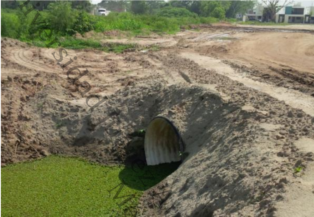
Figura 8. Ducto Pluvial clausurado ubicado en el Fraccionamiento en construcción “Valle del Jaguar”, en la microcuenca Mazaltepec Distrito XII (Loma de Caballo). Dimensiones interiores 1.60 de diámetro.
