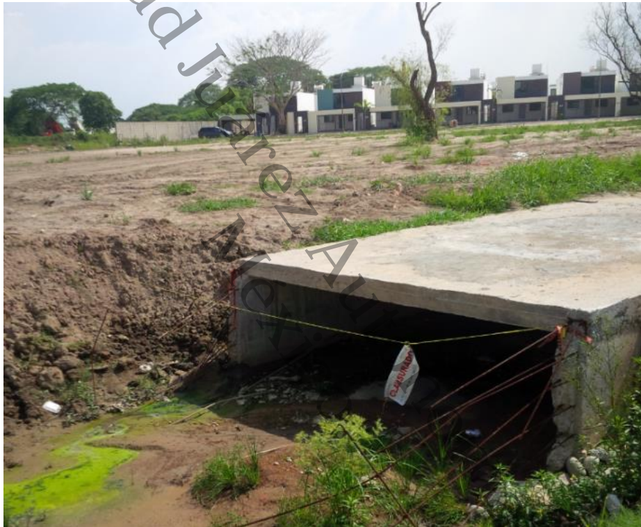
Figura 7. Ducto Pluvial clausurado por CONAGUA ubicado en el Fraccionamiento en construcción “Valle del Jaguar”, en la microcuenca Mazaltepec Distrito XII (Loma de Caballo). Dimensiones interiores 4.00 de ancho y 1.10 de altura
