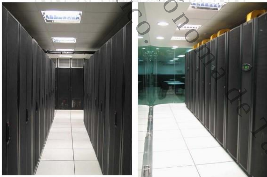
Ilustración 7 Servidores del centro de datos de la UJAT
