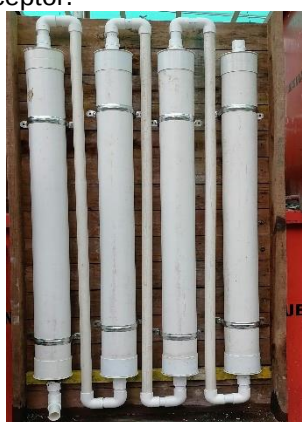
Figura 26. Arreglo de la batería de filtros.
