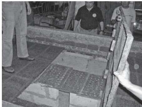
Figura 16. Aspecto del ducto cubierto con placa metálica multiperforada
