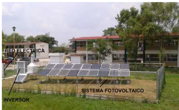
Sistema fotovoltaicos instalado en la DAIA-UJAT y conectado a la red eléctrica.
