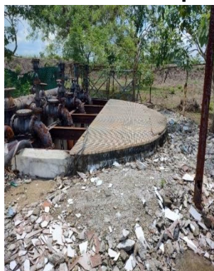
Figura 48 Cárcamo PTAR El Encanto.
