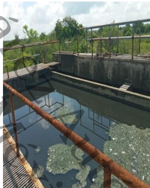
Figura 54. Tanque Imhoff PTAR 27 de Octubre.
