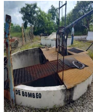
Figura 55. Cárcamo PTAR El Encanto.
