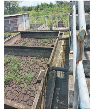
Figura 52. Lecho de secado PTAR 27 de Octubre.
