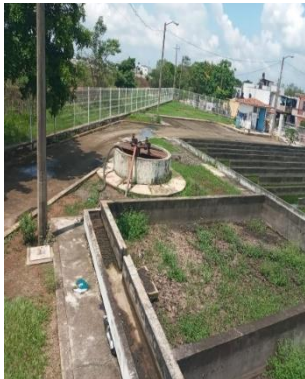
Figura 53. Cárcamo PTAR 27 de Octubre.
