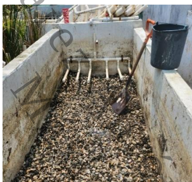
Llenado de los reactores con grava
