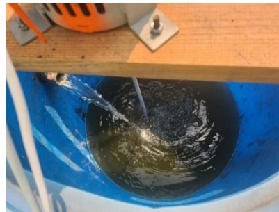
Agitador en funcionamiento en el tanque de distribución de los HA
