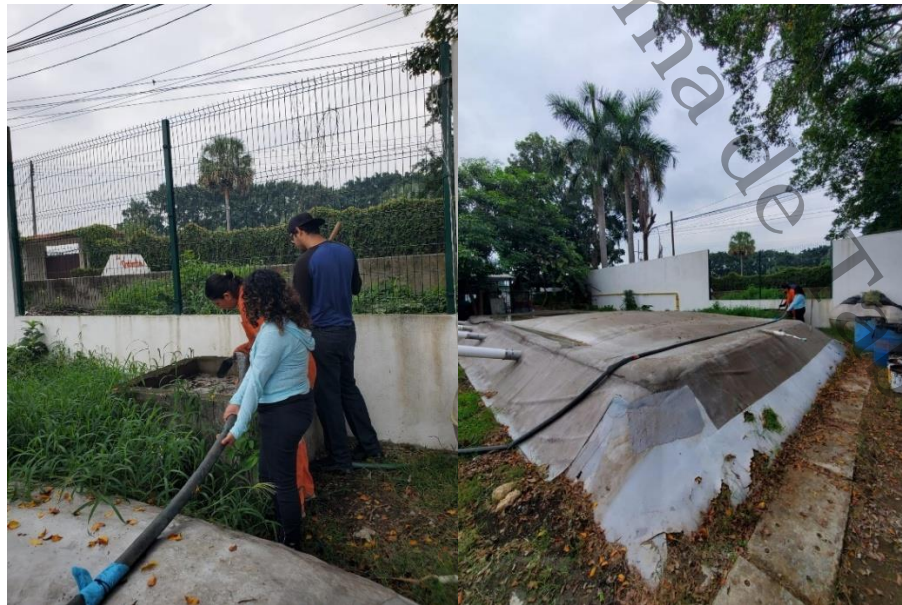
Figura 6. Alimentación de biodigestor.
