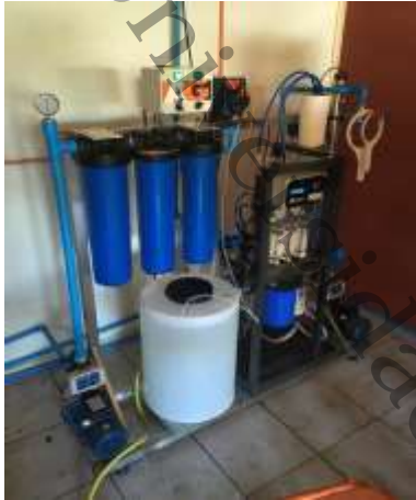
Figura 23. Sistema de Ósmosis Inversa de una Ventana de Autoservicio.
