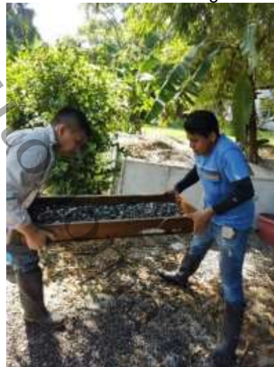
Figura 337. Lavado de medio de soporte. Fuente: FB Laboratorio del agua.
