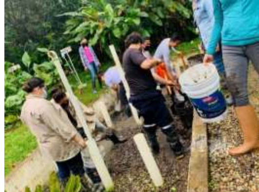
Figura 315. Lavado de medio de soporte. Fuente: FB Laboratorio del agua.
