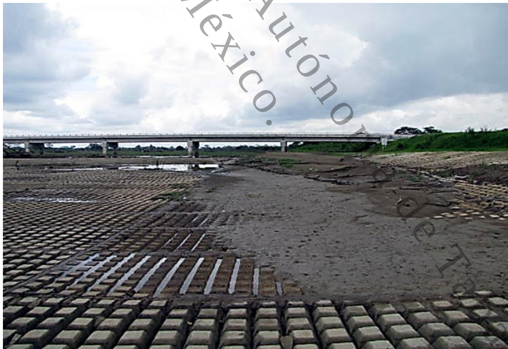
Figura 3.3 Sedimentos depositados en la margen derecha del canal derivador El Censo
