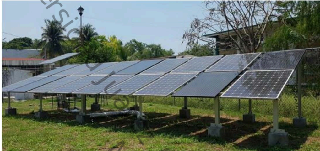
Figura 3.2. Sistema fotovoltaico de la DAIA.
