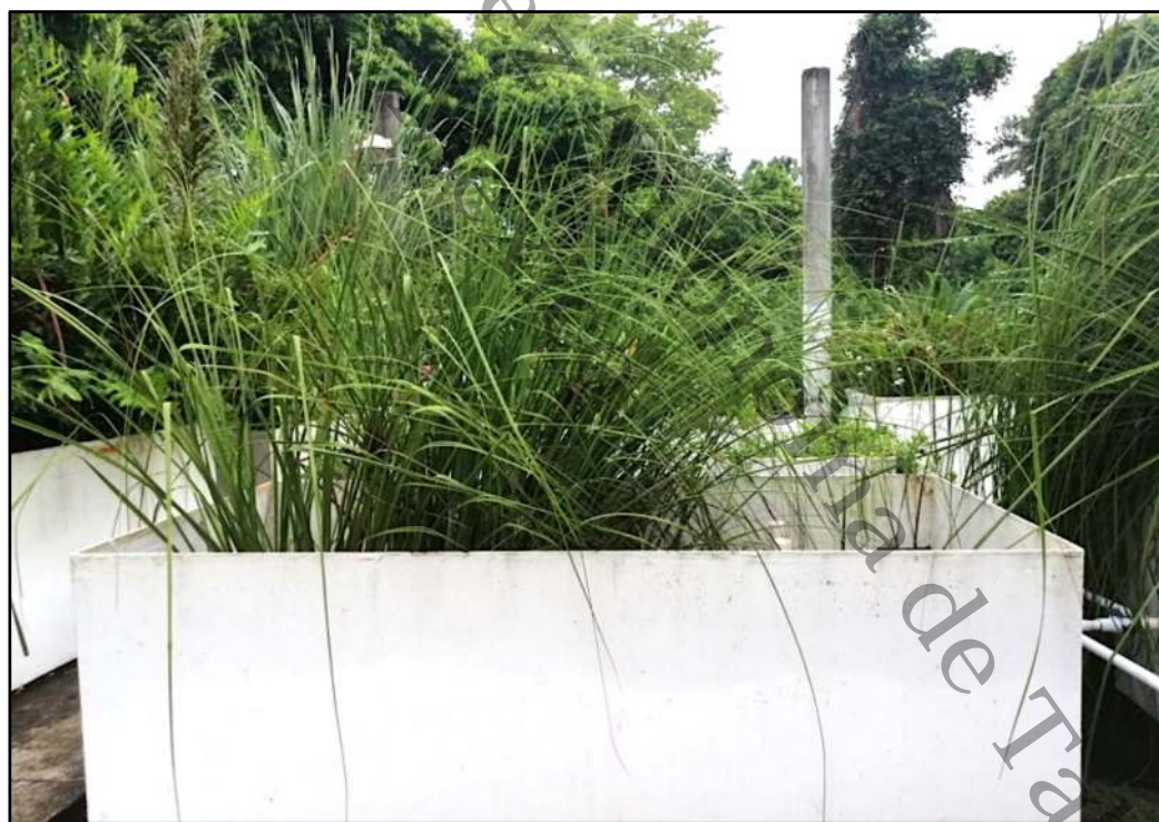
Figura 37. Humedal artificial de flujo libre después de 6 meses de operación.
