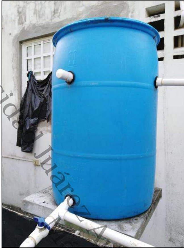
Figura 12. Tanque de alimentación (control) del agua residual.
