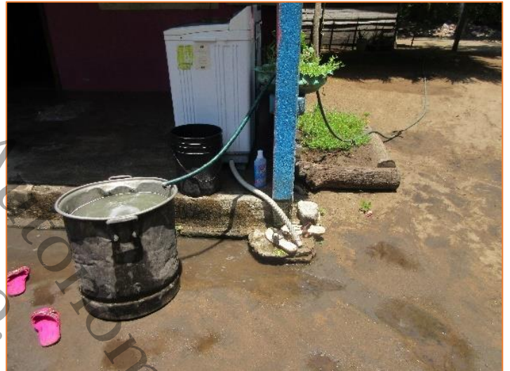
Vertimiento de aguas grises directo al suelo
