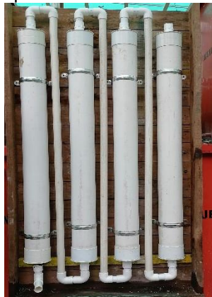
Figura 26. Arreglo de la batería de filtros.
