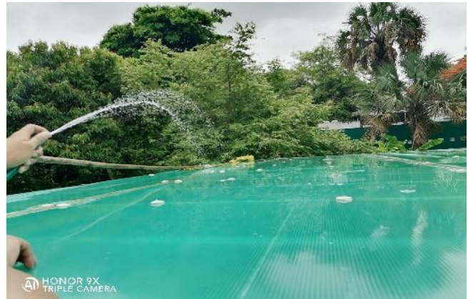
Figura 19. Techo limpio para la captación del agua de lluvia.
