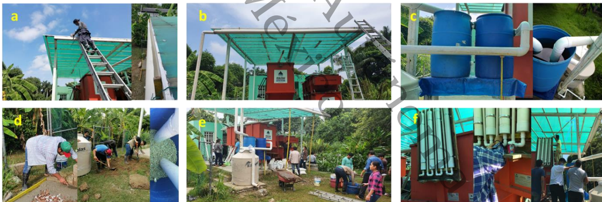
Figura 7. Sistema experimental de captación y tratamiento de agua de lluvia DACBiol-UJAT.
